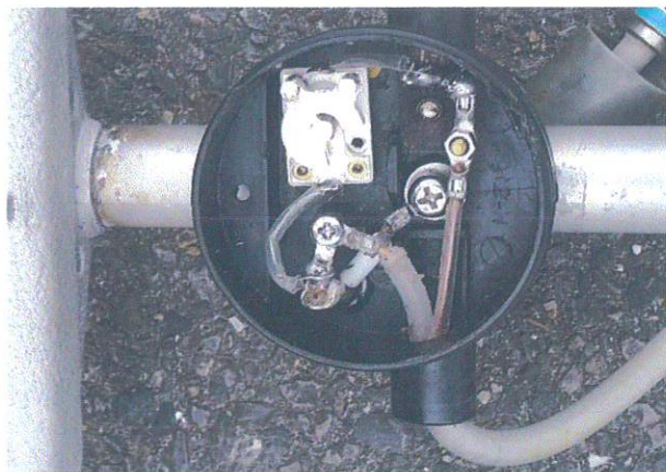
写真左 給電部内部
